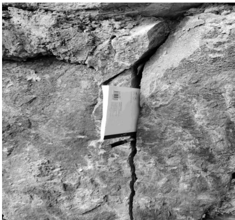
图 4 竖向裂缝 L02 拉裂挡土墙块石
